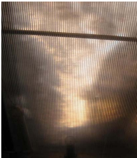
Рис. 5. Фотография слоя снега над подогреваемой крышей зимнего сада
